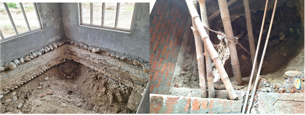
तस्विर १९: सुन्दरनगरमा निर्माणाधिन पक्की घरको जगमा बाढीले परेको असर
